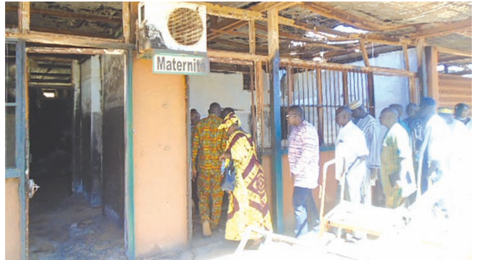
Rien n'a été épargné par les flammes lors de l'incendie de la maternité de Kongoussi le 20 août 2018.
