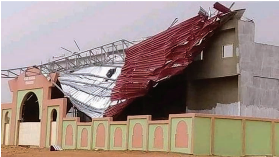
La tribune officielle du stade de Tenkodogo après le passage du vent le 4 mai dernier.
